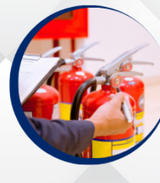
Extintores de Incêndio
