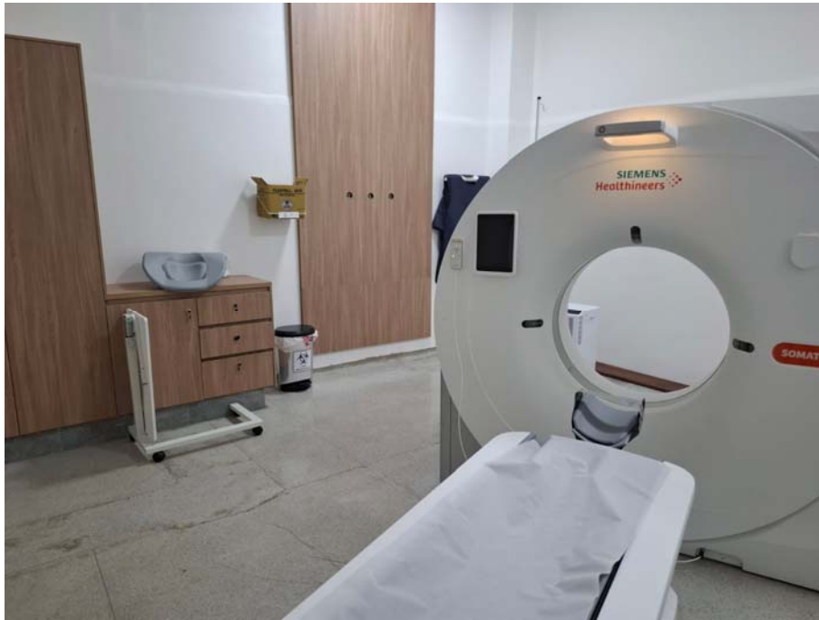
Imagem 03 – Sala de Tomografia Computadorizada.
