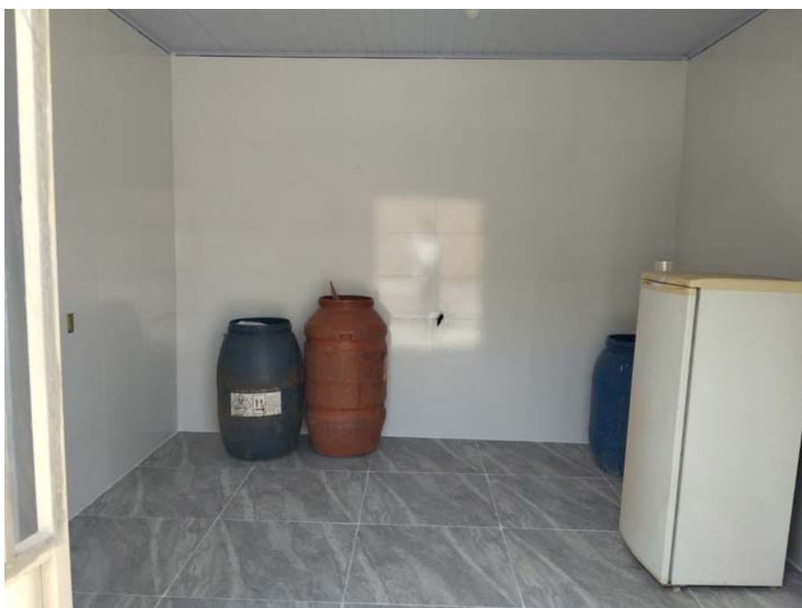
Imagem 10 – Demonstra abrigo externo para armazenamento dos RSS em conformidade com a RDC 222/2018, dotado de piso, paredes e teto de material resistente, lavável e de fácil higienização, com aberturas para ventilação e com tela de proteção contra acesso de vetores.
